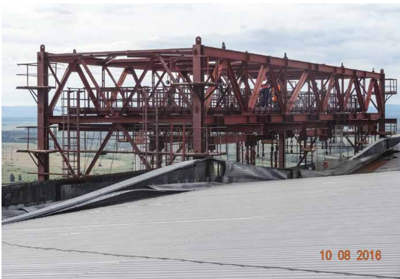
Страховочный блок покрытия на кровле КО
